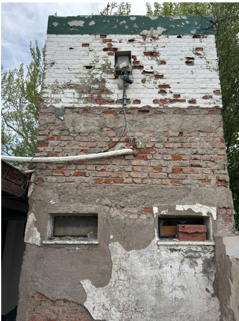
Foto desde afuera de la sala de tanques en uno de sus laterales
